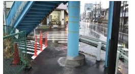
その後一部改善された志茂歩道橋
